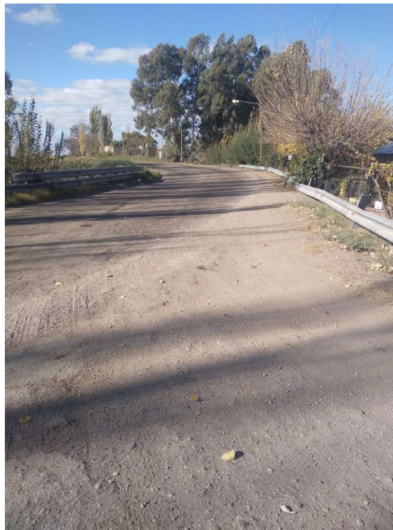
Foto Nº 3: Curva de la Draga estado de barandas metálicas a reemplazar .
