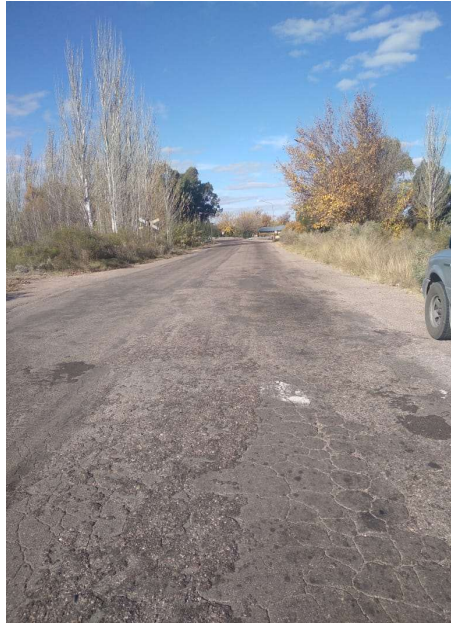
Foto Nº 2: Estado del Pavimento Actual y banquetas.
