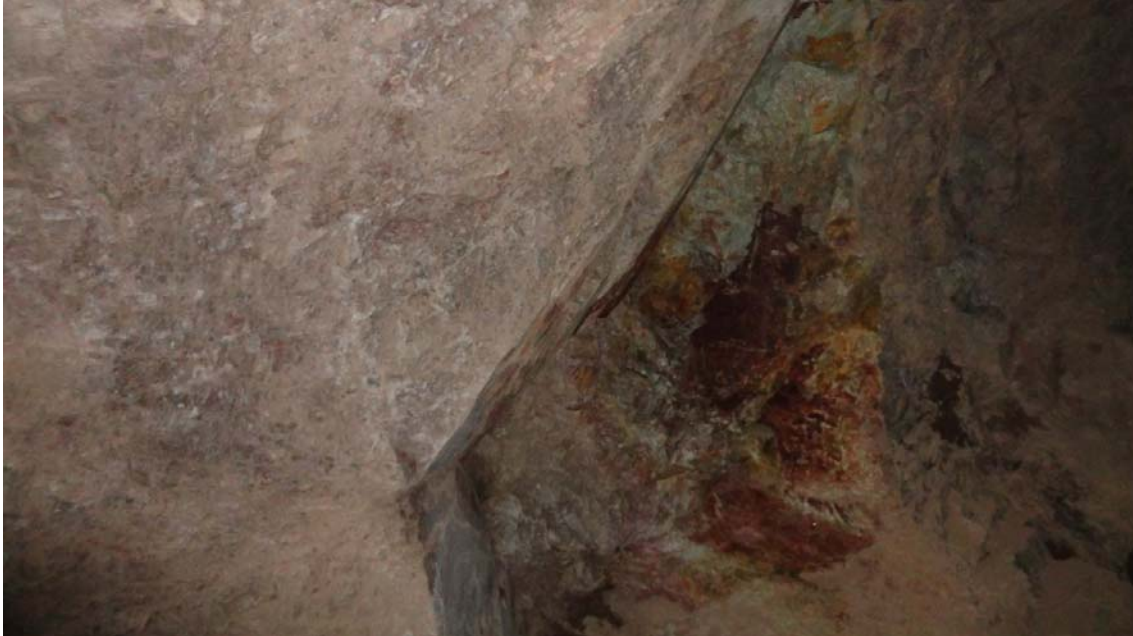
Vista de la Bóveda en zona de derrumbe
